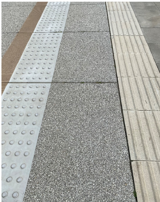
Fot. 5. Przykład fakturowego oznaczenia typu A i B na peronie dworca kolejowego
